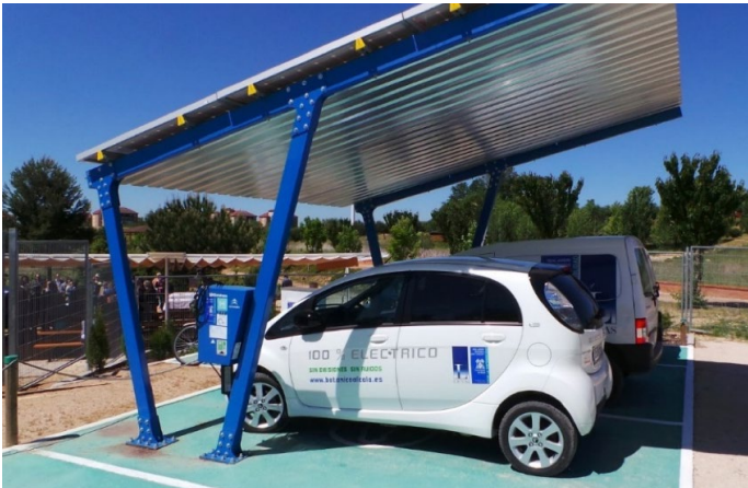
Sistemas de autos eléctricos compartidos, con recarga mediante energía solar, España
